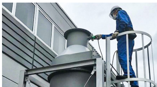
排気口でのばい煙の測定
