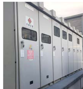
2020年度 高圧受電設備更新
