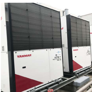
▲2015年度よりガス設備 (GHP) 更新
