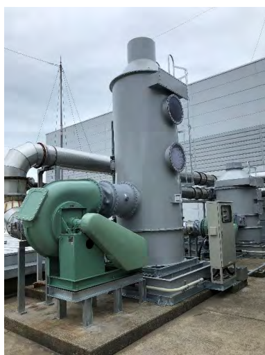
ばい煙対策のための設備更新
