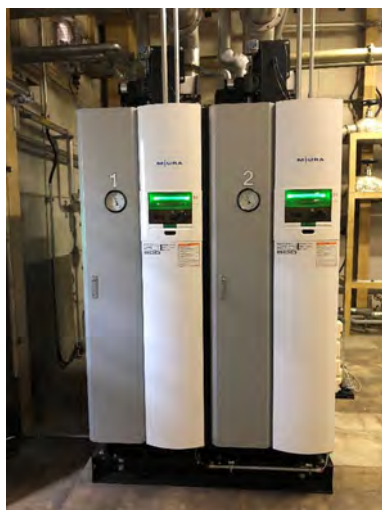
ガスボイラーへの変更による燃焼効率化
